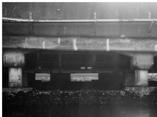
栈橋部の損傷状況
